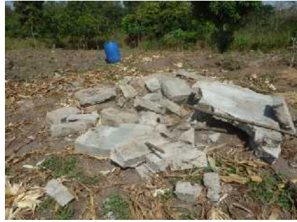
Réservoir d'eau détruit sous la pression de l'eau
