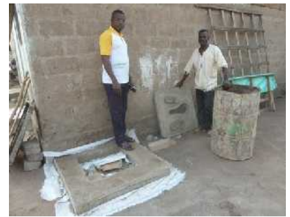
Yao et Elie avec le soubassement et la sanplat fabriquée avec le moule et un tonneau
