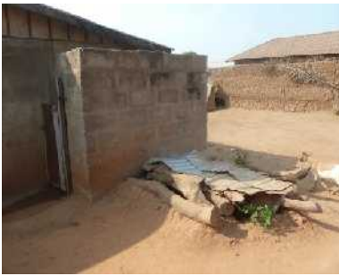
Cabine douche-WC avec une demi-porte mais sans toit et puisard pour la douche
