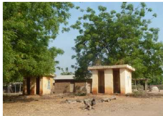
Latrines condamnées en 2013
