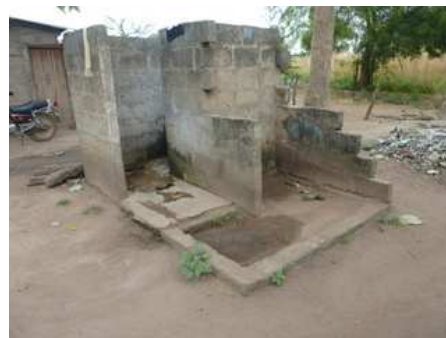
Urinoir accolé à une douche à l'auberge Le Paysan à Ouessè
